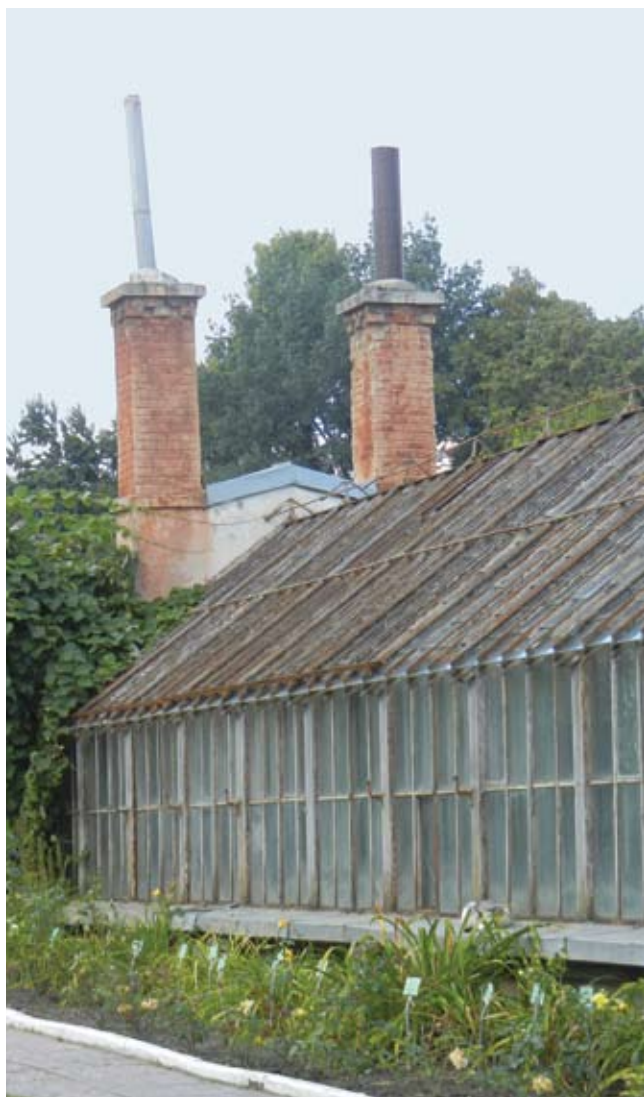
Fot. 1. Kominy kanałów w szczycie szklarni
